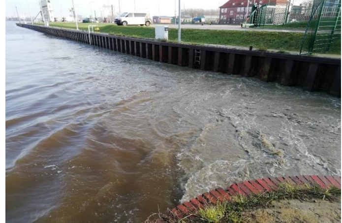
Betrieb des Hafenspumpwerks
