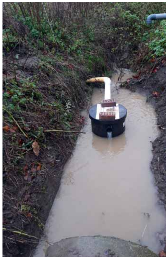
FIGUUR 1: EEN P-FILTER OPGESTELD IN HET VELD. HET UITEINDE VAN DE DRAINAGE-BUIS IS VERBONDEN MET DE P-FILTER DIE IN DE BEEK STAAT.
